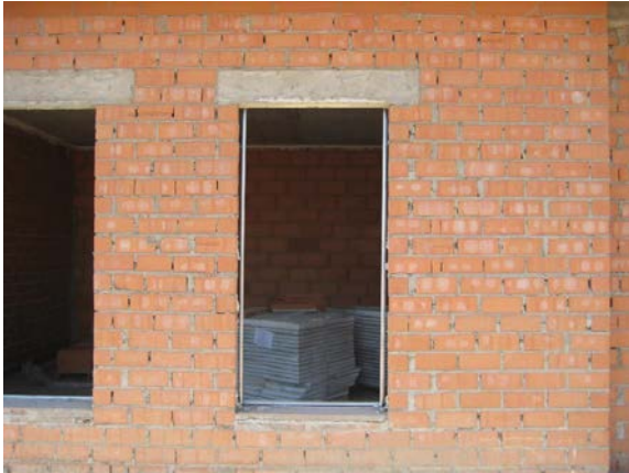
Foto J – Formación cargadero con viguetas de hormigón en hueco de ventana con apoyos entre 10 y 20cm. Precerco de menor dimensión que el hueco
