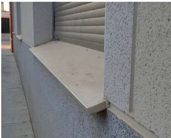
Foto H – Vierteaguas de piedra artificial con pendiente, vuelo y entrega lateral adecuados, aunque carece de la realización de un goterón
