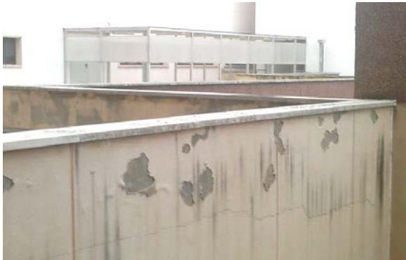
Foto L – Peto de cubierta y colocación de vierteaguas sin pendiente ni goterón, originando la suciedad del paramento y desprendimiento de la pintura
