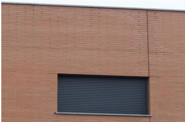
Foto K – Junta de dilatación coincidente con la jamba de ventana. Posibilidad de filtraciones al ser un encuentro crítico.
