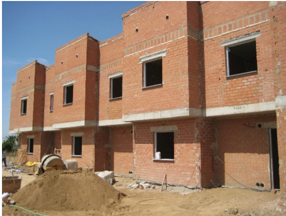
FOTO B – Vista general de hoja principal de fachada en ejecución de viviendas pareadas.
