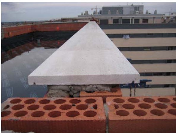
Foto E – Colocación sobre peto de una albardilla sin pendiente. Incorrecto
