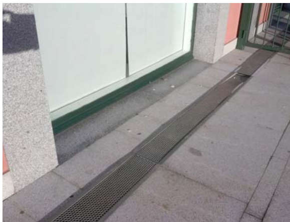
Foto 1 – Sumidero lineal en cubierta plana transitable con solado de granito
