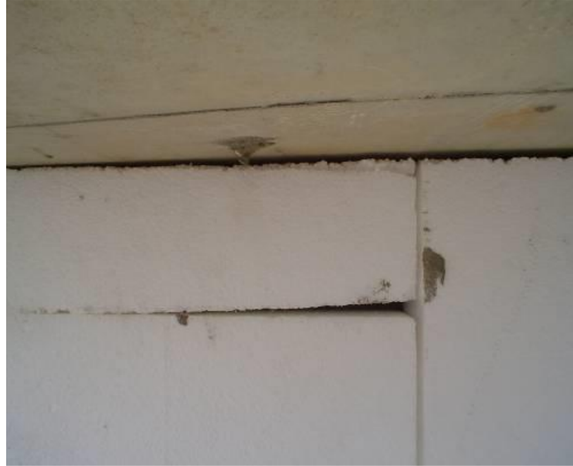
Evitar huecos entre placas ya que provocan puentes térmicos.
